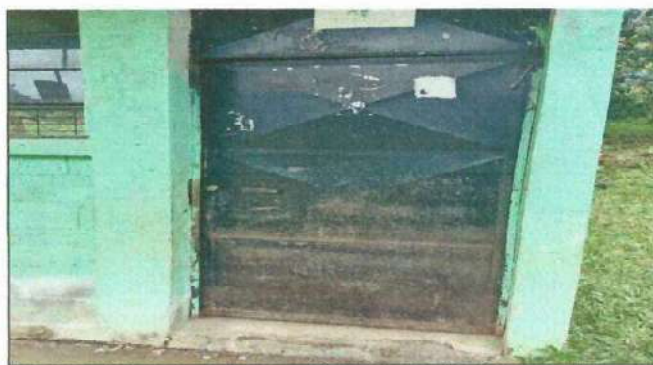
Foto 4: SUSTITUCION DE PUERTAS DE METAL EN MAL ESTADO
